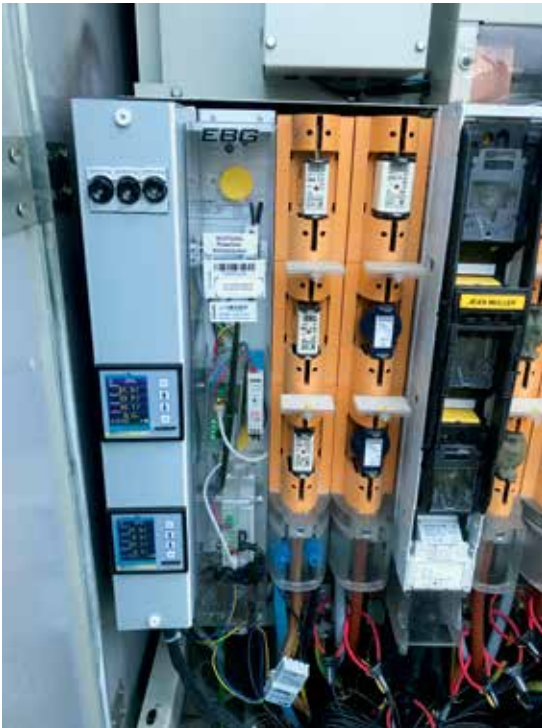
Niederspannungsstation der SH Netz AG mit zwei Messgeräten, die per LoRaWAN ausgelesen werden, sowie Powerline-Komponenten
